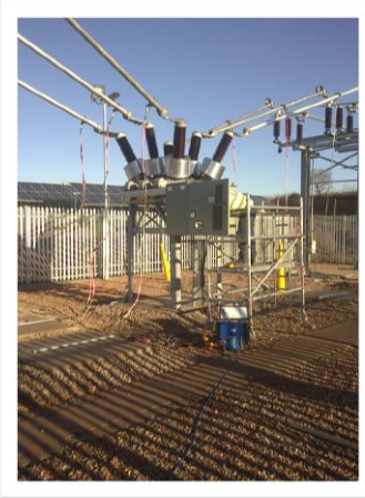
Siemens 66kV Breaker
