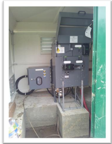
11kV Schneider Switchgear
